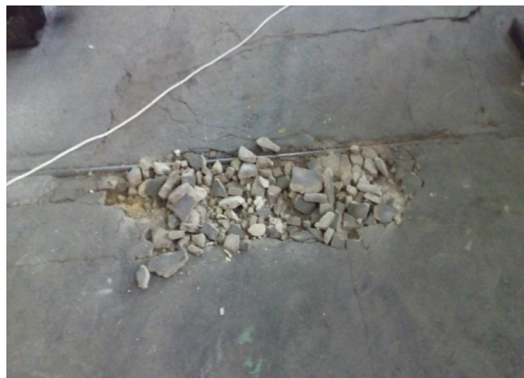
Рисунок 5 - Разрушение стяжки пола
