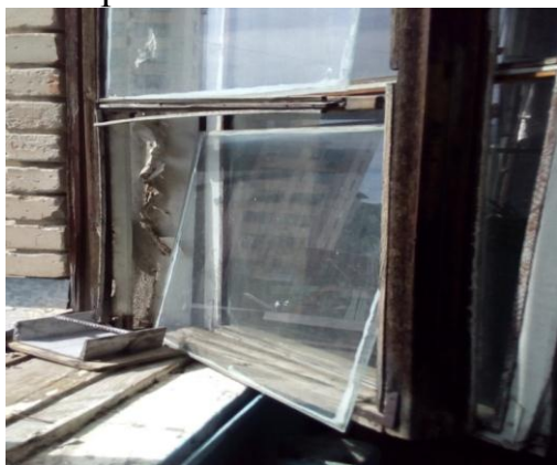
Рисунок 6 - Разрушение оконных рам
